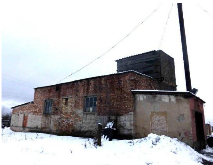
Рисунок 4 – Внешний вид котельной д. Турово
