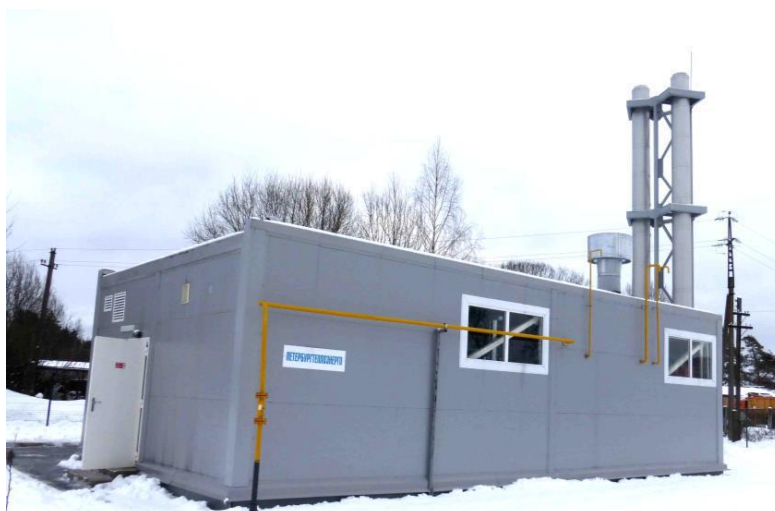
Рисунок 3 – Внешний вид котельной д. Каменка
