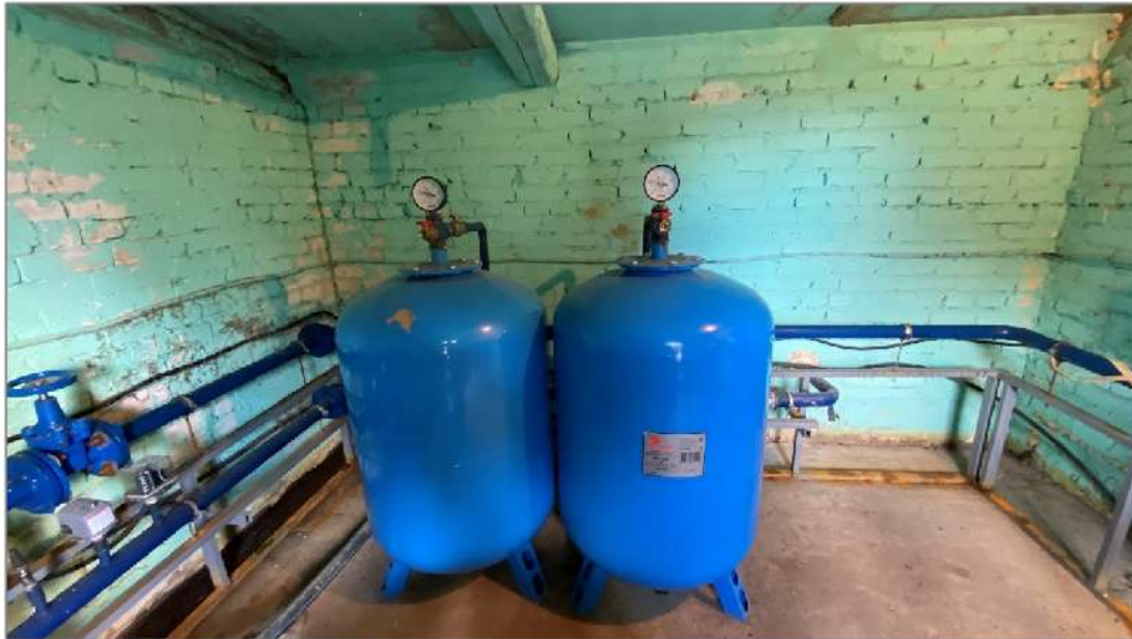
Баки для системы водоснабжения д. Турово
