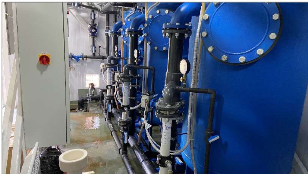
Оборудование контейнерной станции водоподготовки
