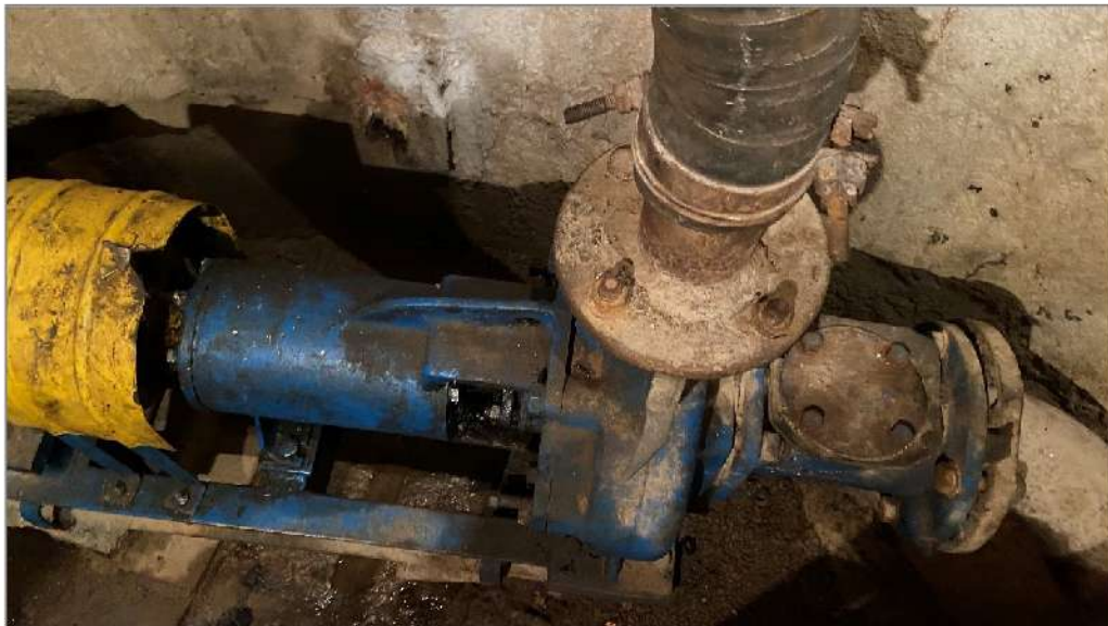
Насос КНС у дома №30.
