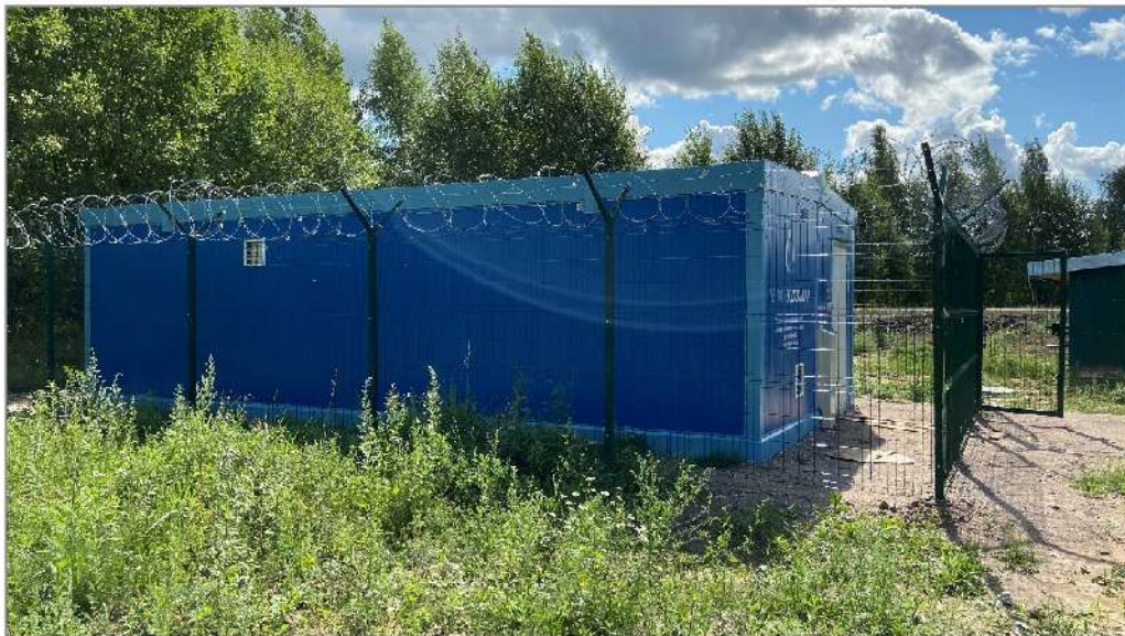
Контейнерная станция водоподготовки в д. Турово
