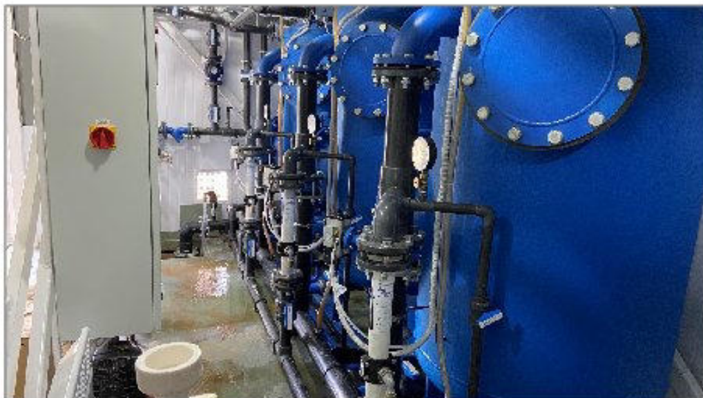
Оборудование контейнерной станции водоподготовки
