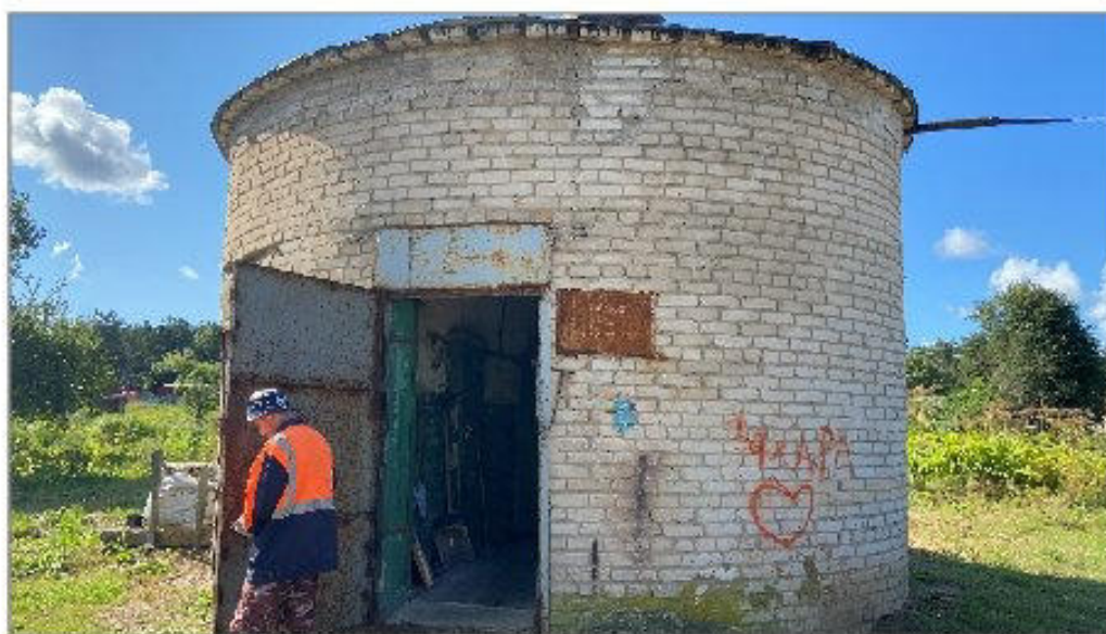
Комплексная насосная станция д. Заклинье.
