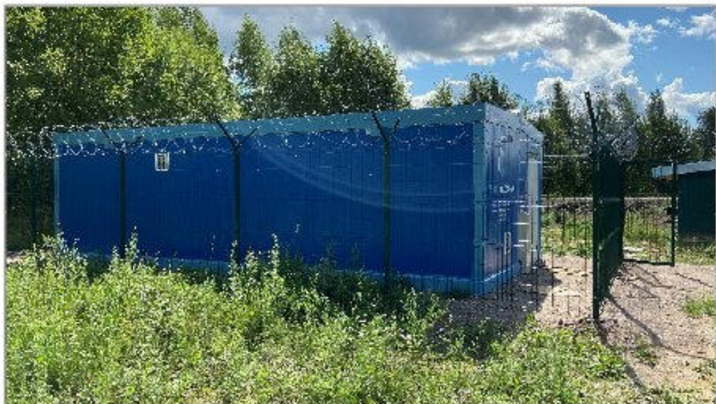
Контейнерная станция водоподготовки в д. Турово
