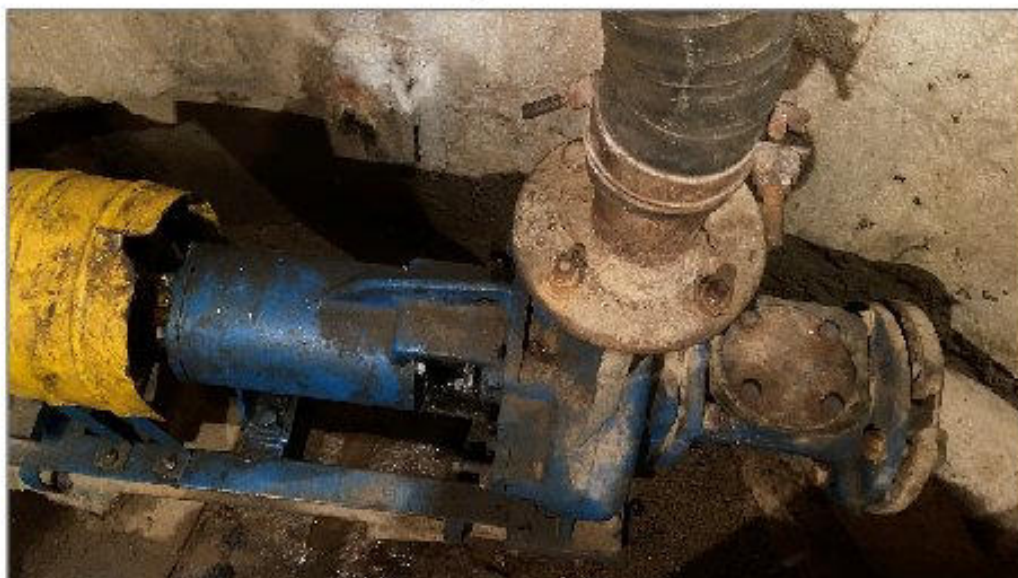
Насос КНС у дома №30.
