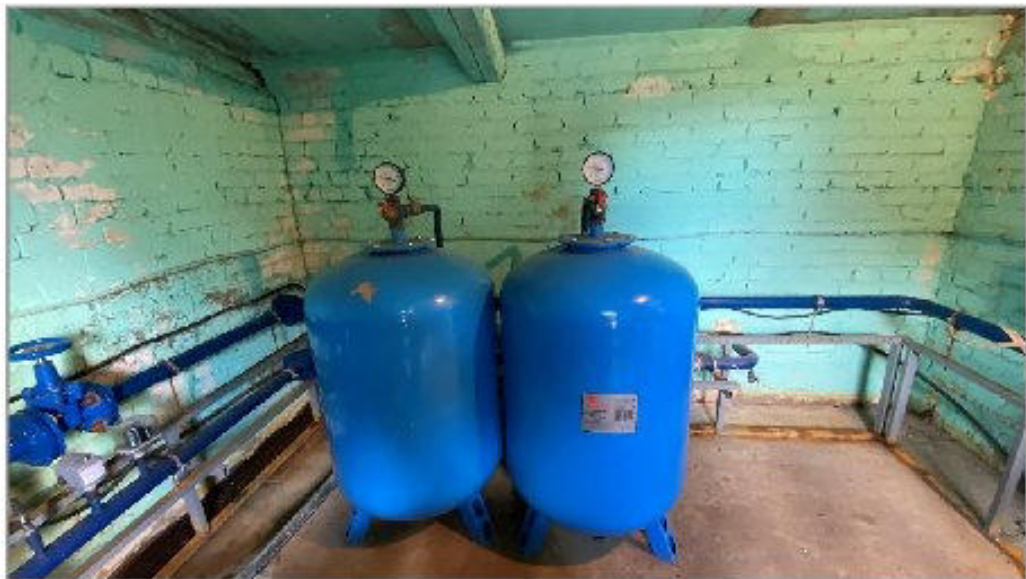
Баки для системы водоснабжения д. Турово
